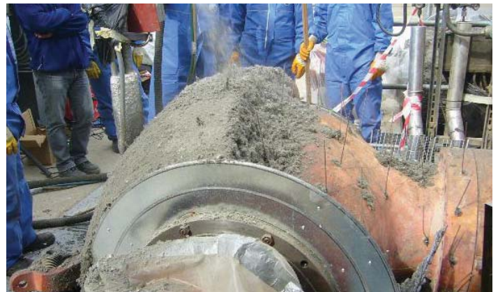
Protection contre le feu dans des turbines à Warsaw University of Technology
