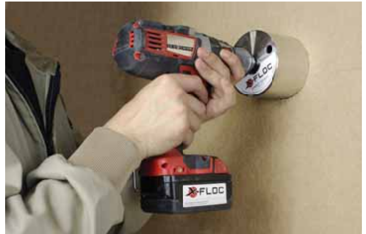
Scie cloche HF pour des ouvertures d'insufflation précises dans les panneaux de fibres de bois tendres
